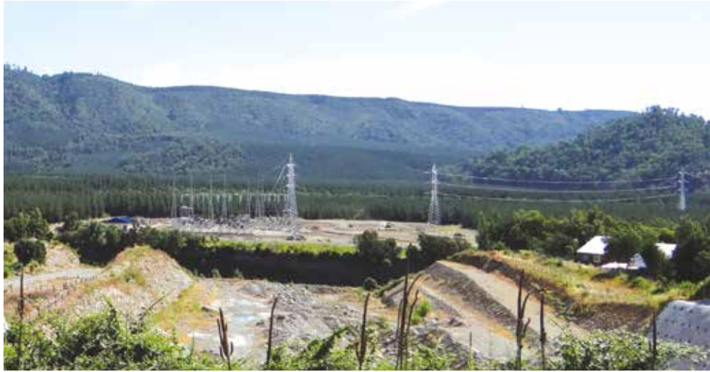
FIGURA 22. Vista de tendidos eléctricos
